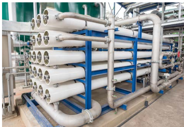
Sistema di osmosi inversa di un impianto di dissalazione.
